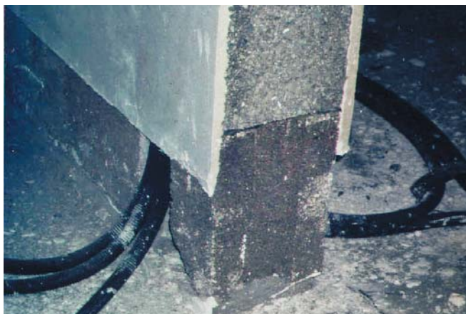
Verschiedene Ausführungen der Kimmschicht im Passivhausbau (von links): Innenwand mit Kimmschicht aus Bims, daneben eine Betonwand mit in die Schalung eingelegter Polystyrol-Hartschaumdämmung
