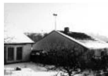
Abb. 12: Schlechte Wärmedämmung im Dach des rechten Hauses; im Gegensatz zum linken Haus schmilzt der Schnee
