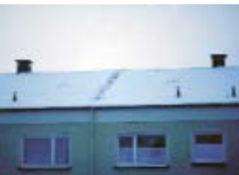
Abb 13: Beispiel einer Wärmebrücke: Im Bereich des gedämmten Dachs treten geringe Wärmeverluste auf, der Schnee schmilzt nicht. Über der nicht gedämmten Haus-trennwand entweicht viel Wärme, der Schnee schmilzt.
